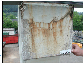
Ettringitschaden bei Kranbahn- konsole
